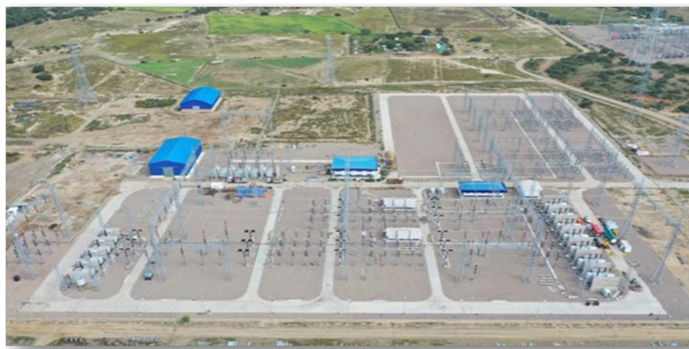
Subestación Santivañez 500 kV
